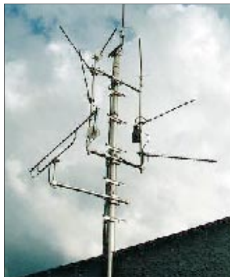
OE9XPR auf dem Dach der Pfänderbahn-Bergstation: für jede Datenfunkstrecke wurde eine eigene Richtantenne montiert. Foto via OE6CLD
