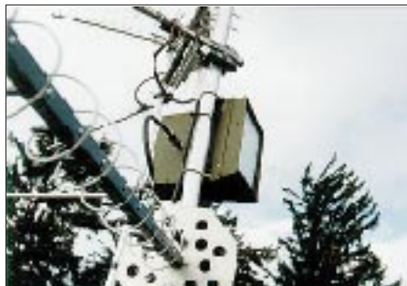
Blick auf die Antennenanlage von OE9XPR
